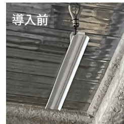
既存LED照明
