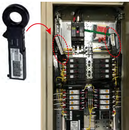
電力ロガーを設置した分電盤
